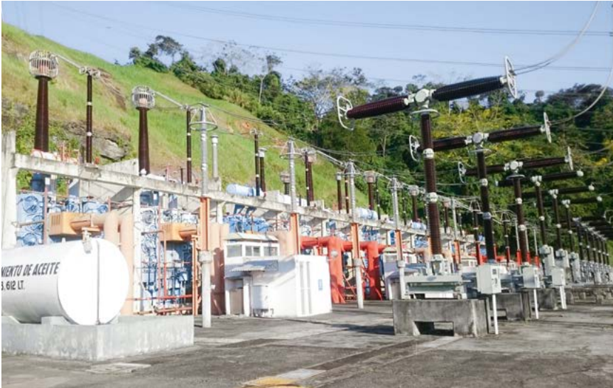
Transformateurs principaux de Malpaso
