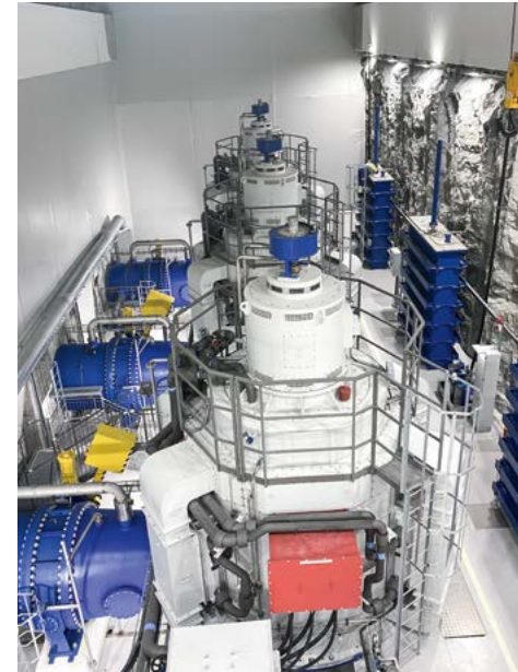
Centrale électrique de Tolga. La nouvelle centrale au fil de l'eau est équipée de trois turbines Francis compactes identiques de 15 MW.
