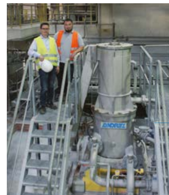
Себастьян Штокфиш, руководитель участка удаления печатных красок и системы очистки сточных вод на комбинате LEIPA (справа), и Маркус Майрич, руководитель проекта от ANDRITZ, рядом с новым фильтром улавливания хвостов ModuScreen T4C
